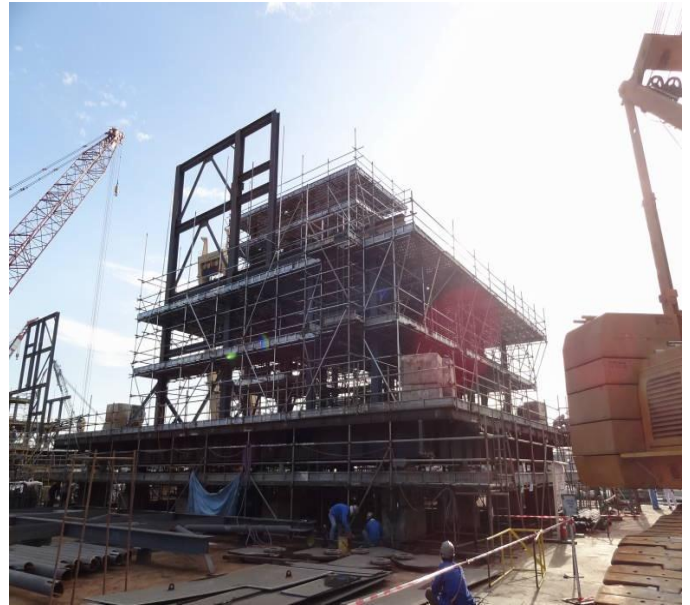
Módulo de Geração de Energia
