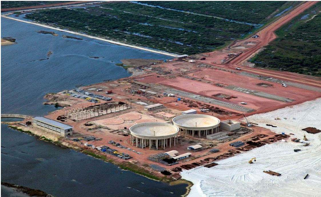
Área de filtragem e estocagem de minério de ferro
