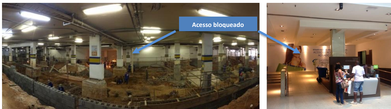
1ª Expansão – Bloqueio do acesso ao shopping e prejuízo à circulação dos clientes
