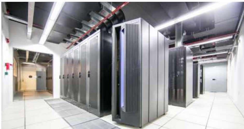
Imagem interna do data center da CSU ITS
