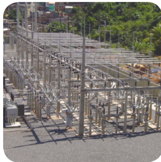
Subestação Narandiba - BA
