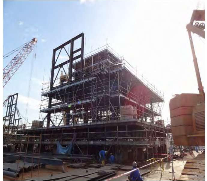
Módulo de Geração de Energia
