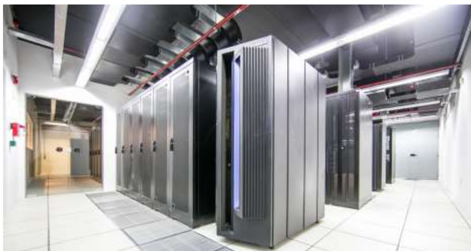
Imagem interna do data center da CSU ITS
