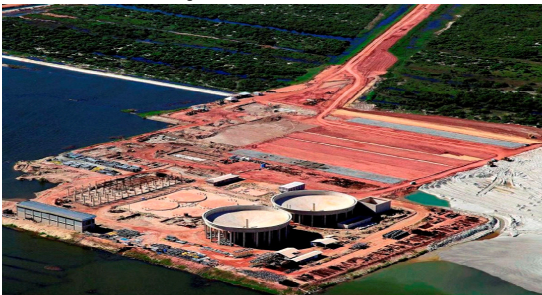
Área de filtragem e estocagem de minério de ferro
