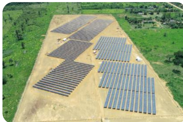
Sistema instalado pela EGSD.
