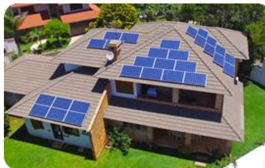
Sistema instalado pela EGSD.
