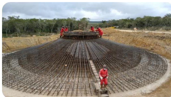
Base do aerogerador - Conjunto Eólico Campo Largo
