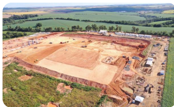
Subestação Ponta Grossa – visão geral
