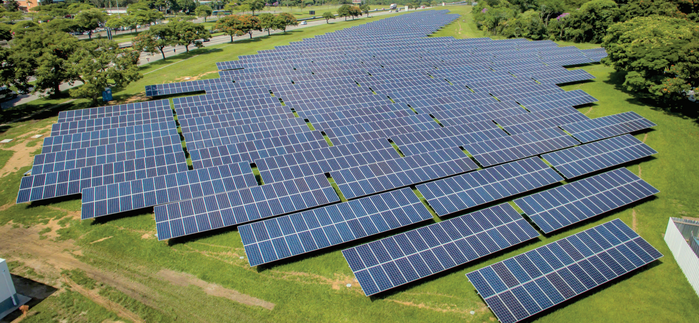
Usina solar construída pela EDP para a Johnson & Johnson em São José dos Campos (SP)
