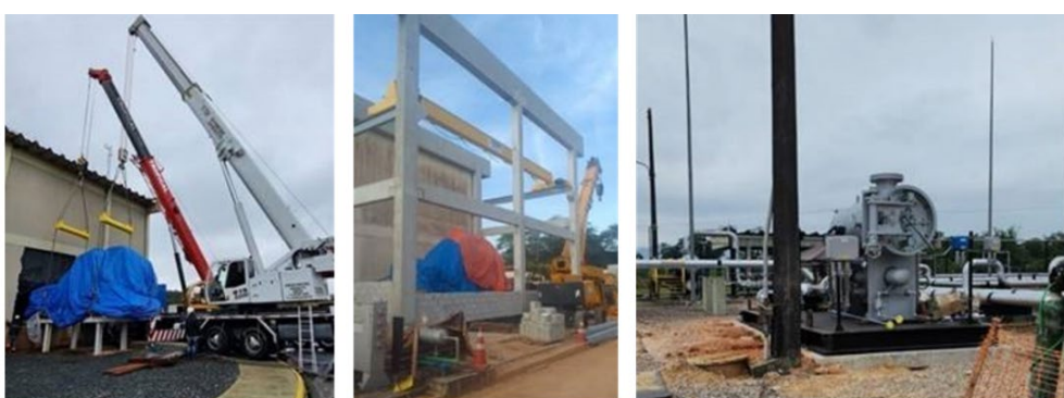
Figura 29 – Retirada do motocompressor de Araucária/PR, montagem da casa e instalação do filtro em Biguaçu/SC
