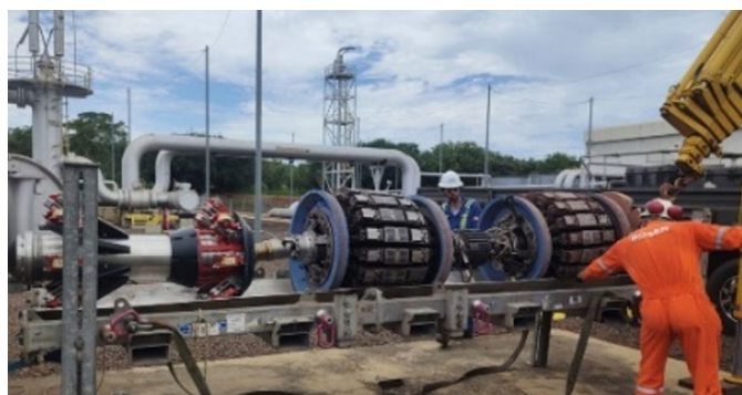
Figura 19 – Inspeção por PIG instrumentado
