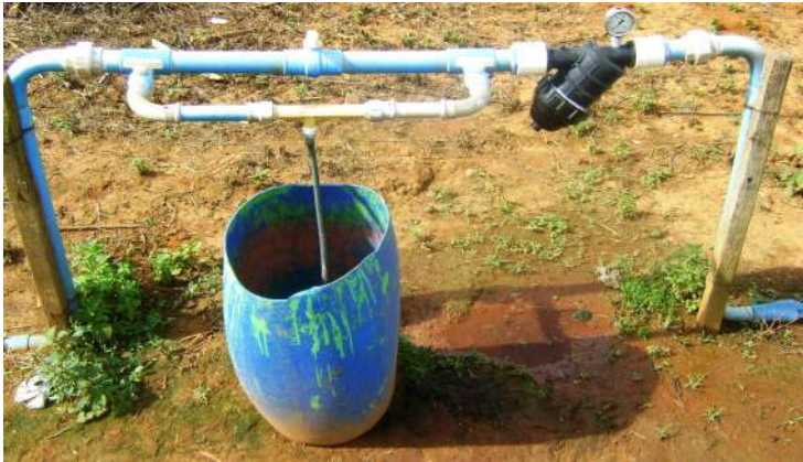
Figura 10. Sistema de Fertirrigação.
